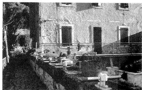
Vannes de réglage
